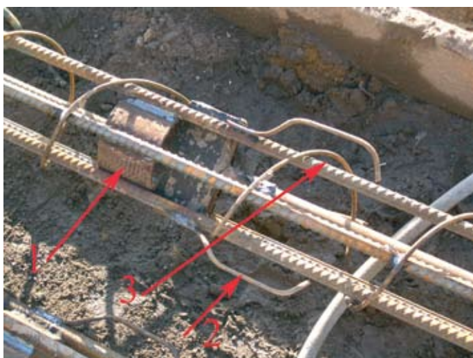
Рисунок 2 Отсутствие сварки поперечной и продольной арматуры каркаса (указано стрелкой 3).
