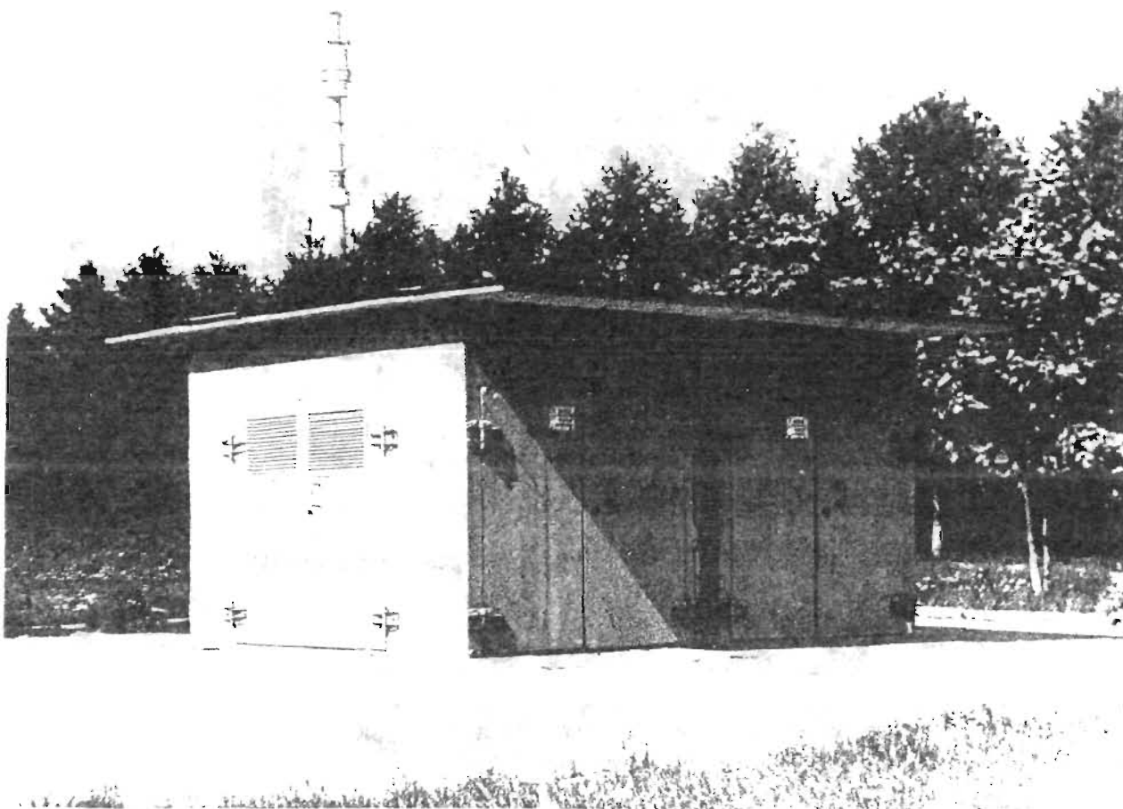
Фото 8. KTP 10/0,4 кВ из объемных ж.б. блоков (г.Москва)
