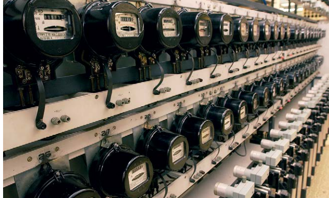
Цех по ремонту счётчиков
